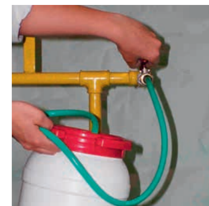
Le liquide d'étanchéité est évacué sur les points les plus bas de l'installation de gaz.
