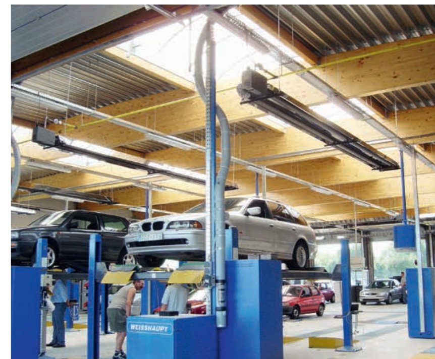
Radiants sombres dans une station de contrôle technique. À cause de la ventilation considérable, le radiant sombre est raccordé comme type A. La ventilation est conforme à la norme EN 13410.
